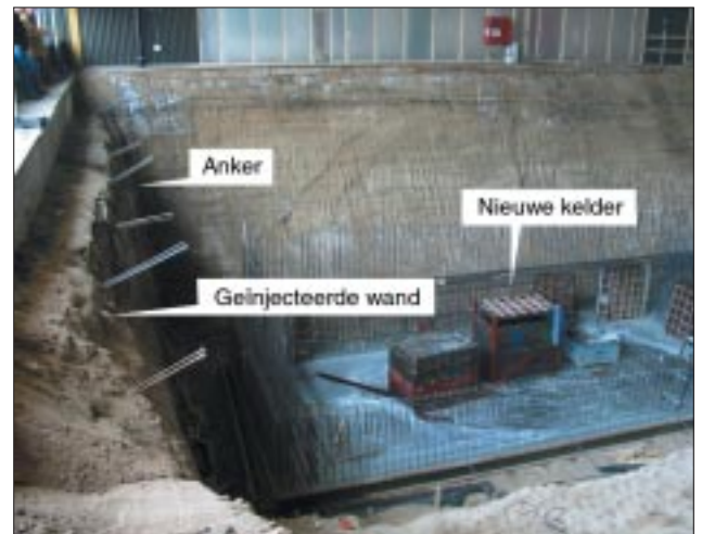
■ Figuur 3: Bovenaanzicht in de hangar
